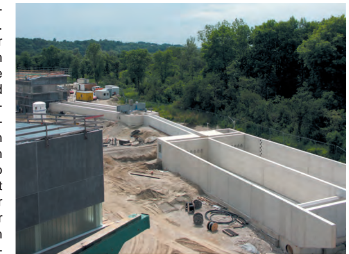
Sand- und Fettfang und im Vordergrund das Vorklärbecken
