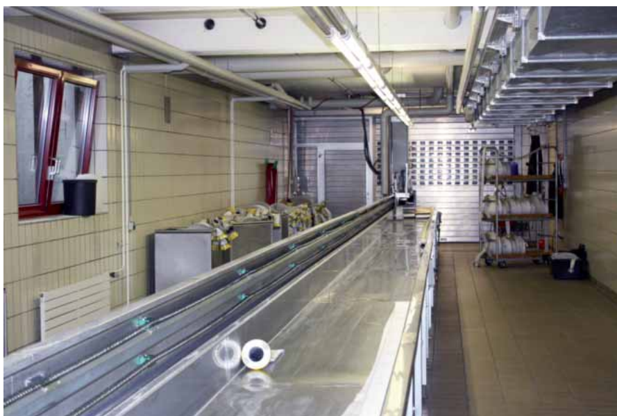
Die Schlauchpflegeanlage in der Feuerwache Dingolfing Im Vordergrund: die Prüfwanne
