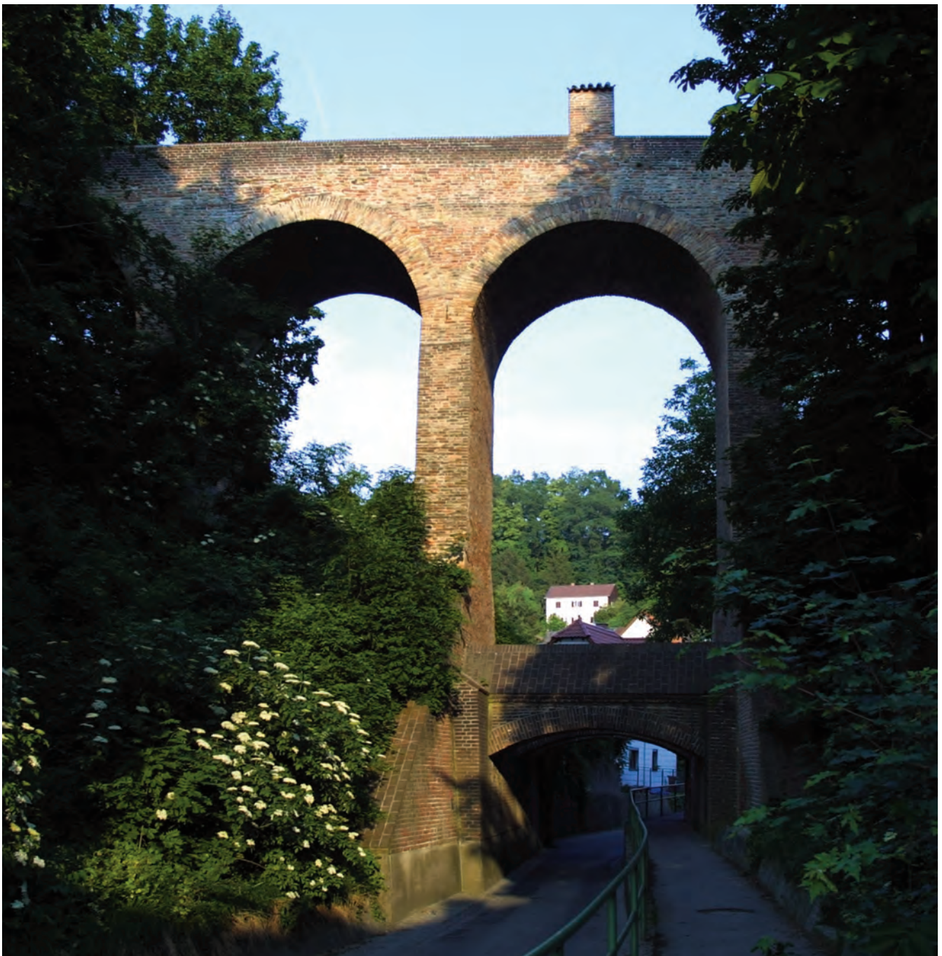
Sanierungsbedürftig: die Hochbrücke
