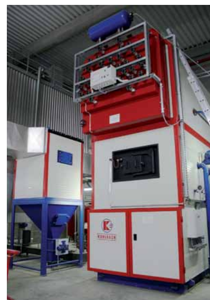
Herzstück der Anlage: die Brennkammer
