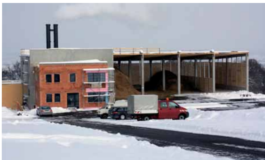
Das neue Heizwerk an der Isarhangleite
